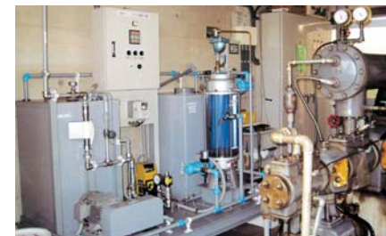
▲「強羅創泉苑」源泉事業所 機械室内部 コンプレッサー スケール防止装置
